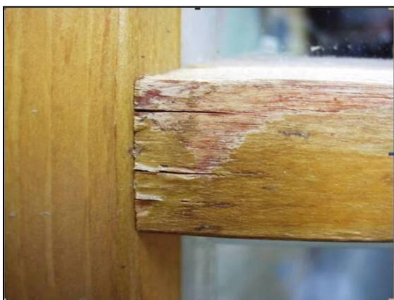
Obr. 4.5: Poškození v oblasti spojů
