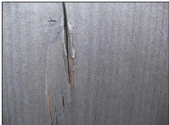
Obr. 2.2: Vznik trhlin a odlupování nátěru
