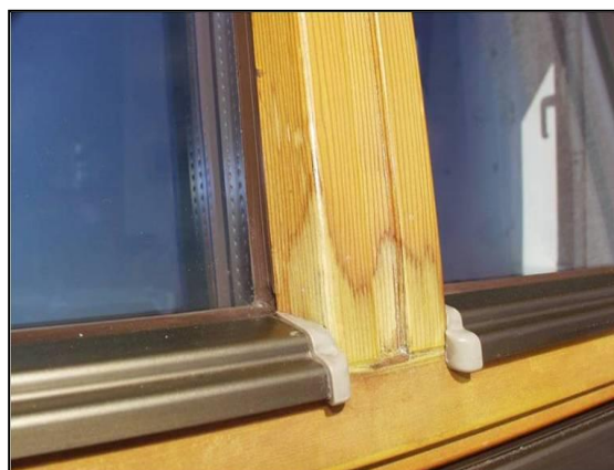
Obr. 4.6: Poškození v oblasti spojů
