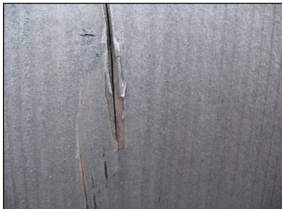
Obr. 2.2: Vznik trhlin a odlupování nátěru
