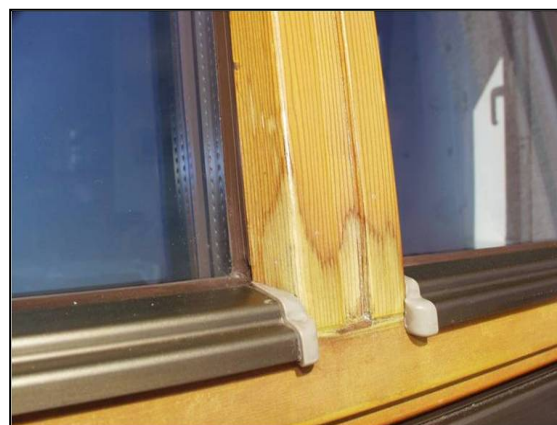
Obr. 4.6: Poškození v oblasti spojů
