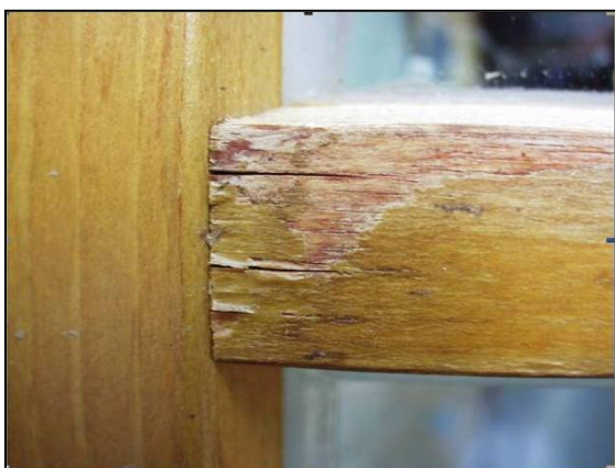
Obr. 4.5: Poškození v oblasti spojů
